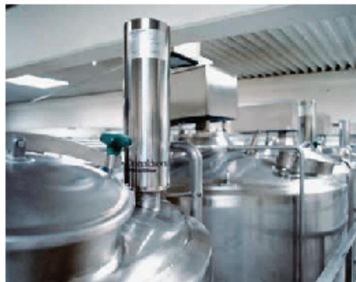
Carcaças de filtros para aerção em tanques de armazenamento.
